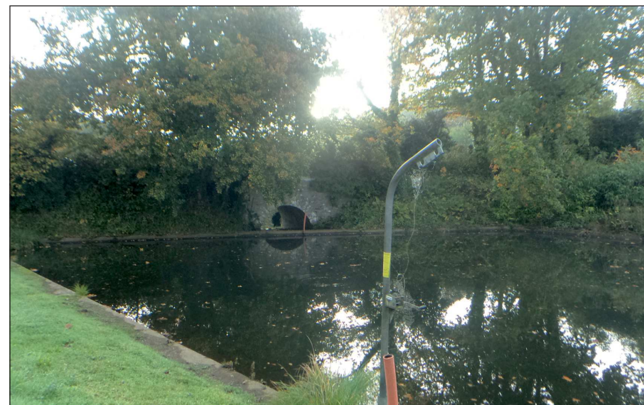
Photographie 6 : Vue du bassin aval depuis l'usine de potabilisation
