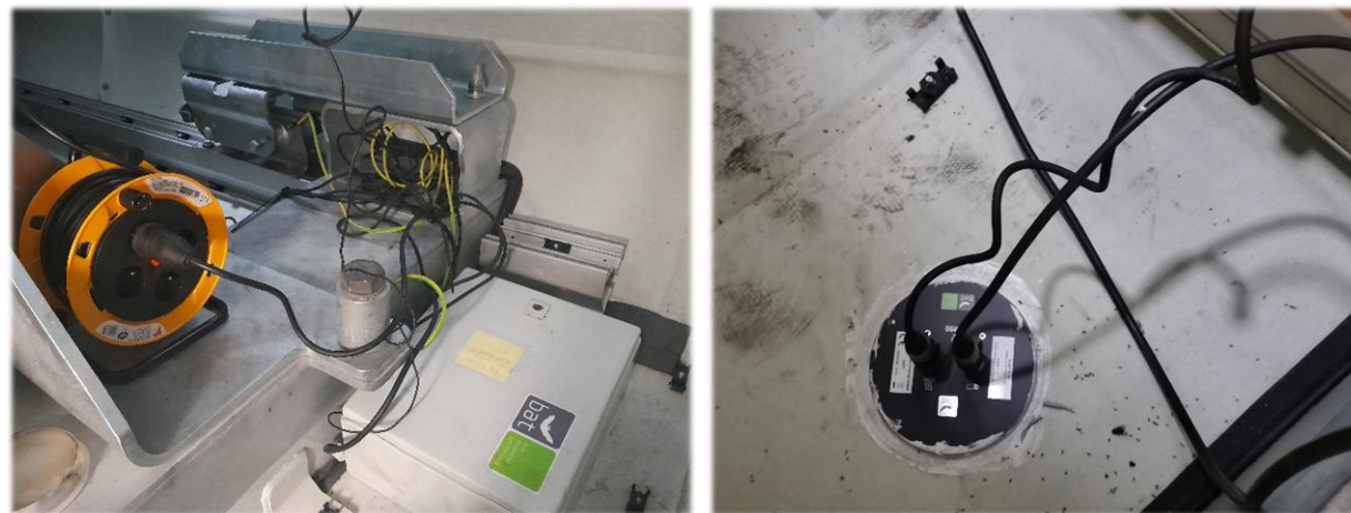
Batmode S+ installé en nacelle (TBM-Écosphère)
