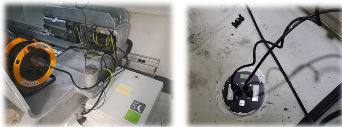
Batmode S+ installé en nacelle (TBM environnement)
