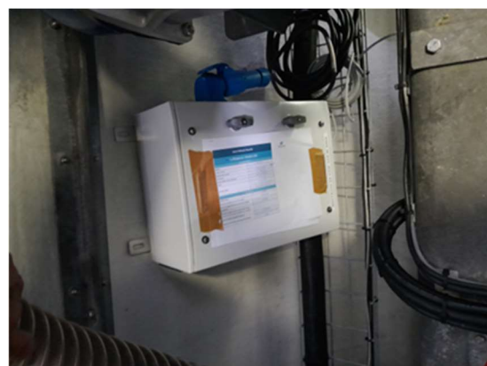
Photo enregistreur dans l'éolienne K4
